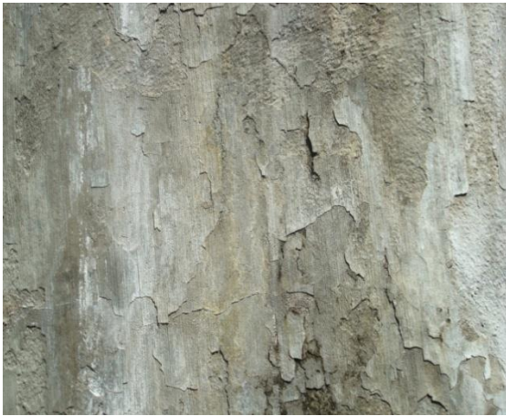
Escamas de pintura y eflorescencia
