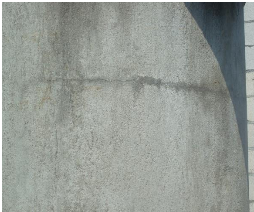
Fisura típica en capa superficial de mortero
