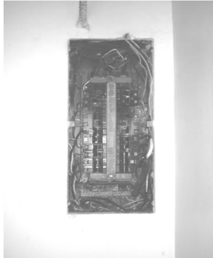
Figura 26. Tablero de distribución eléctrica
